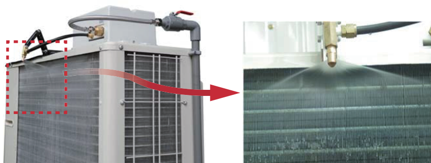
▲節能降溫器灑水頭裝於冷凝器回風側，以一般自來水壓力均勻噴灑在鋁片上，使水霧冷卻降溫發揮最大效益。
